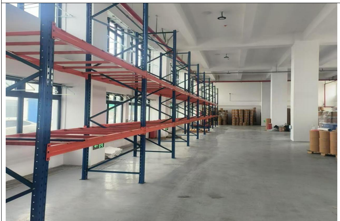
仓储区：原辅材料可能对土壤和地下水产生污染，现场踏勘显示地面均已硬化，并铺设环氧地坪，地面完好无破损裂痕。
