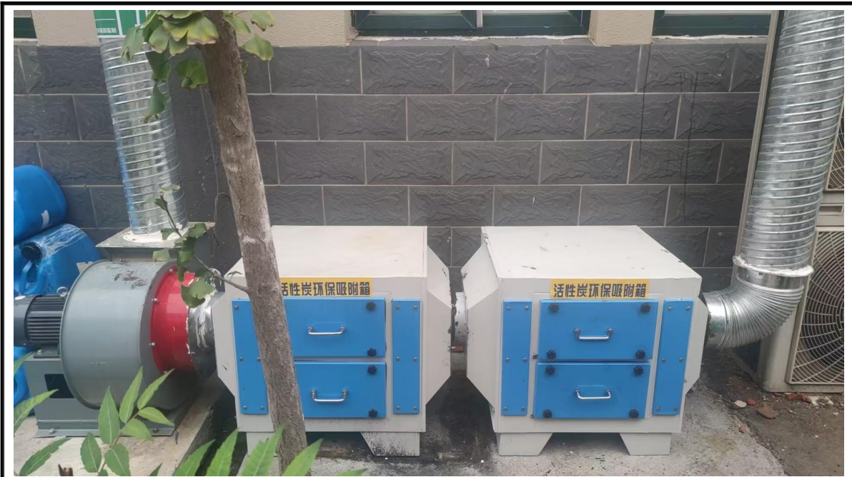
图7-1 废气处理设备
