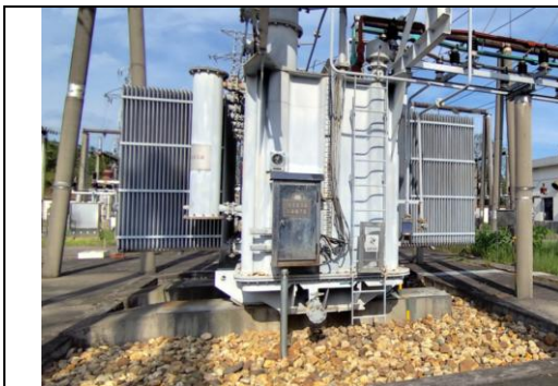
1 号主变及油坑
