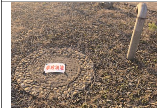
现有事故油池
