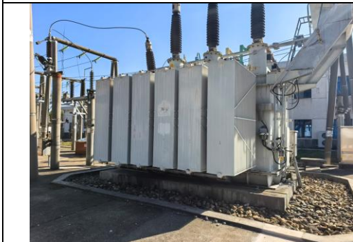
2 号主变及油坑
