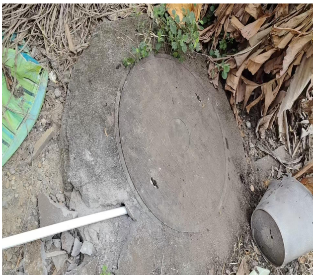
设备间接冷却废水排水管
