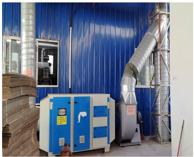
活性炭吸附装置及排气筒
