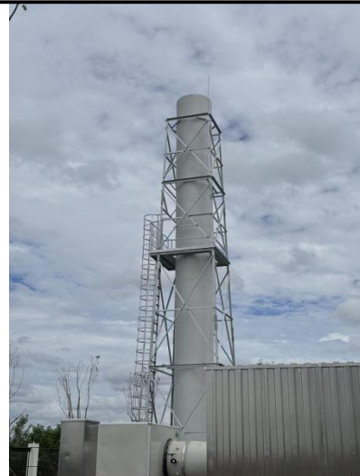
15m 高排气筒
