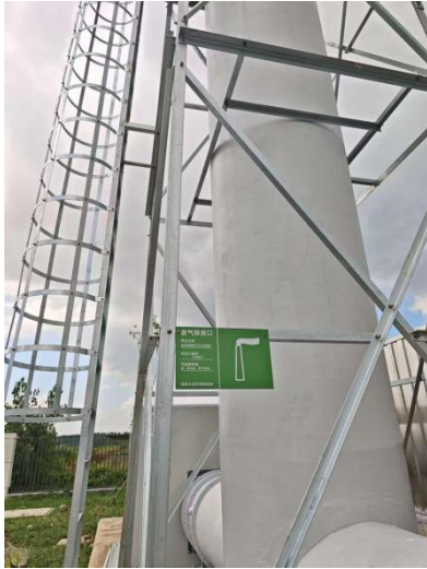
废气排口标识牌
