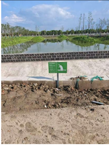
污水排口标识牌
