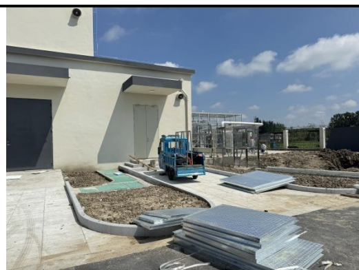
格栅及进水泵房
