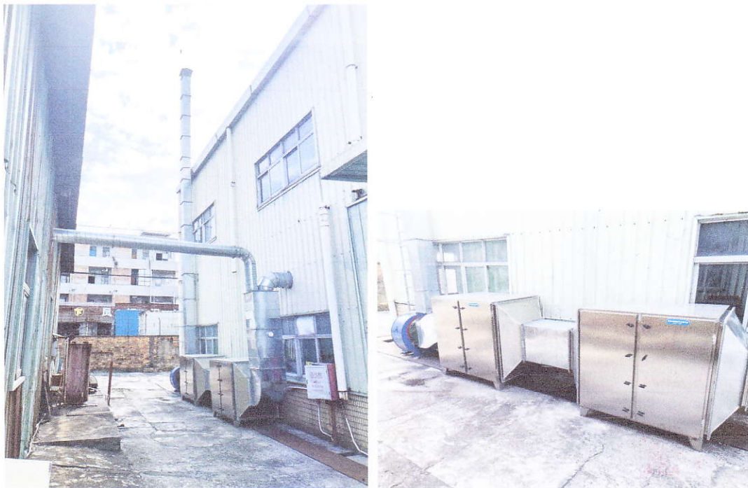
废气治理设施 DA003
