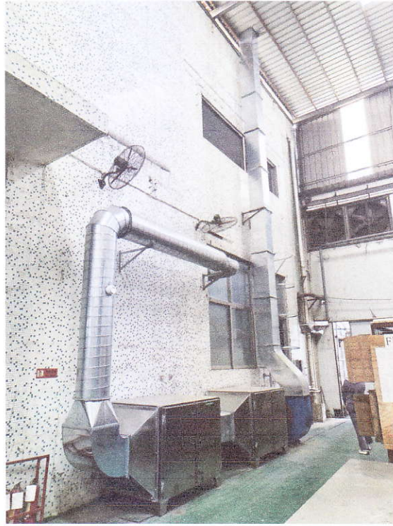
废气治理设施 DA002
