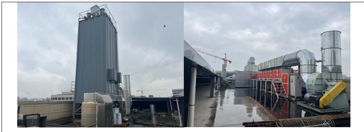
图 4.1-2 废气处理设施
