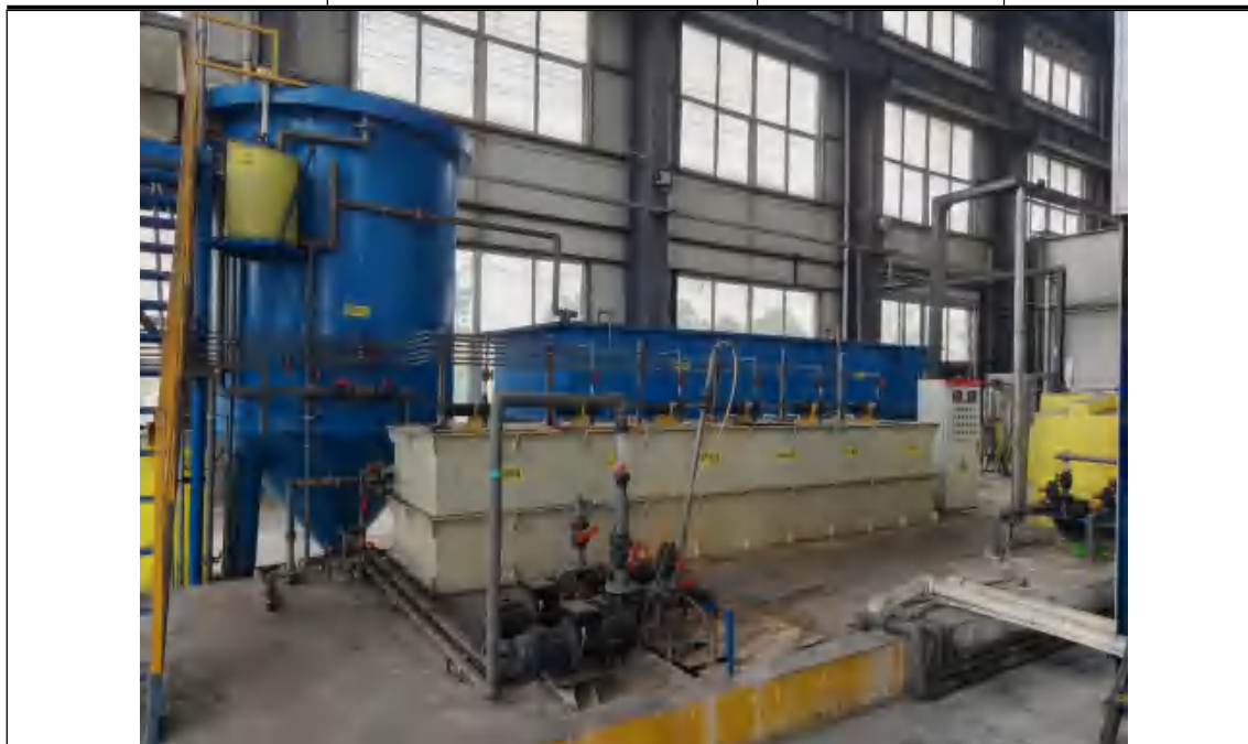
废水预处理系统
