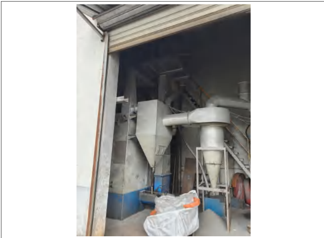
旋风除尘+布袋除尘器-2
