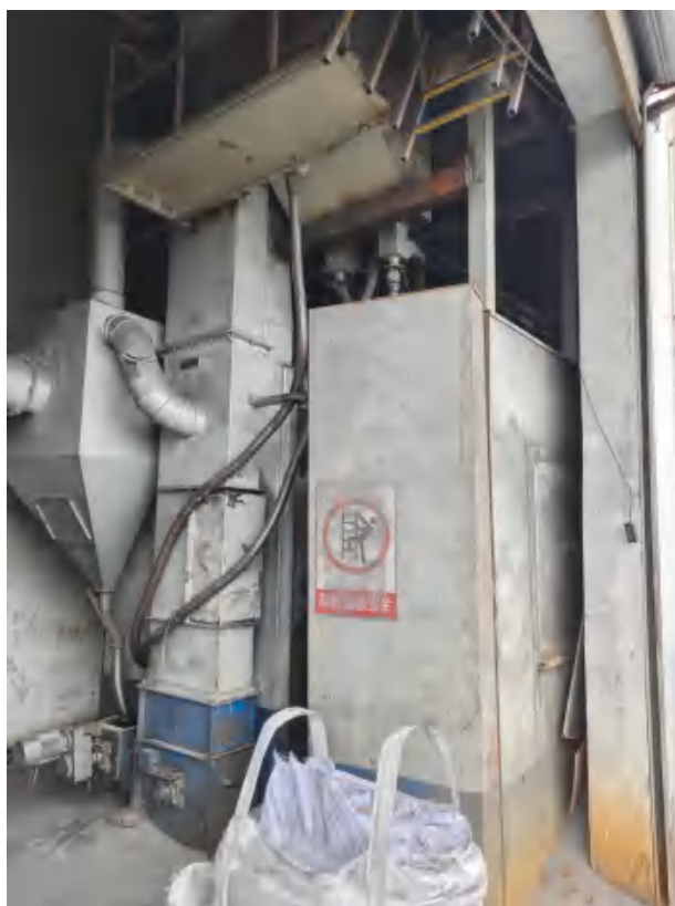
旋风除尘+布袋除尘器-1
