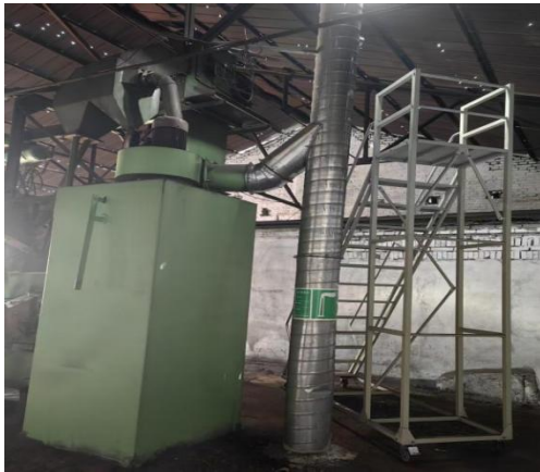
图3 抛丸工序治理设施
