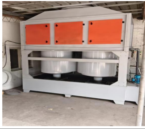
图2 水喷淋治理设施
