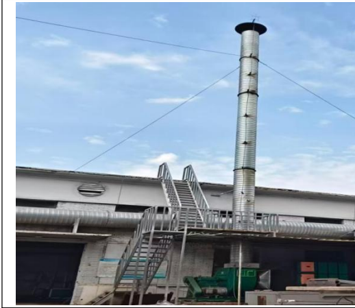
图1 淬火、回火、渗碳工序治理设施
