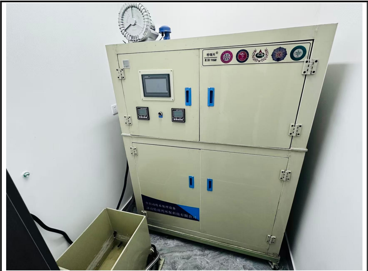
图 7-3 污水处理设施
