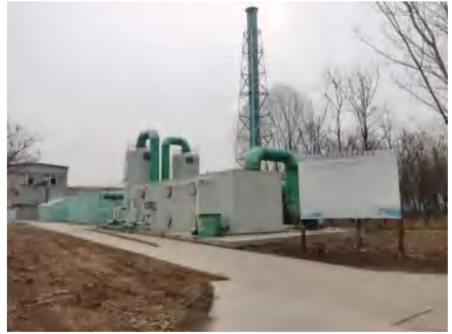
污水处理站废气处理设施及排放口
