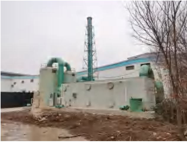
屠宰车间废气治理设施及排放口
