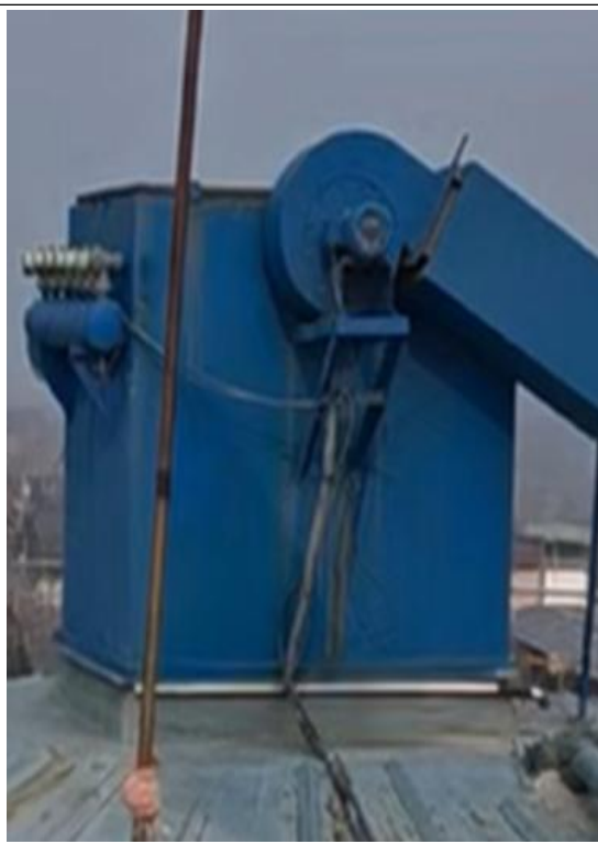
2#储仓罐袋式除尘器 (TA002)
