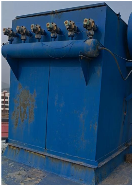
1#储仓罐袋式除尘器 (TA001)
