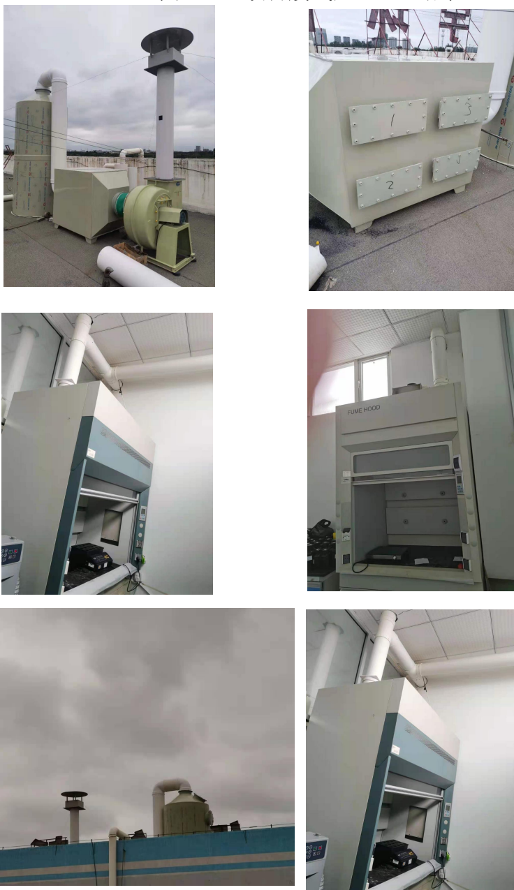
图3-3 项目部分废气收集、处理图片
