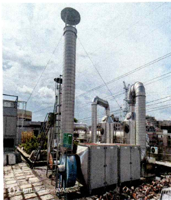
升级原有有机废气处理设施
