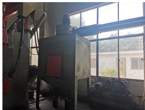
废气处理设施
