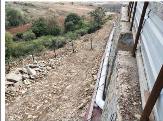
七、粪污收集管道
