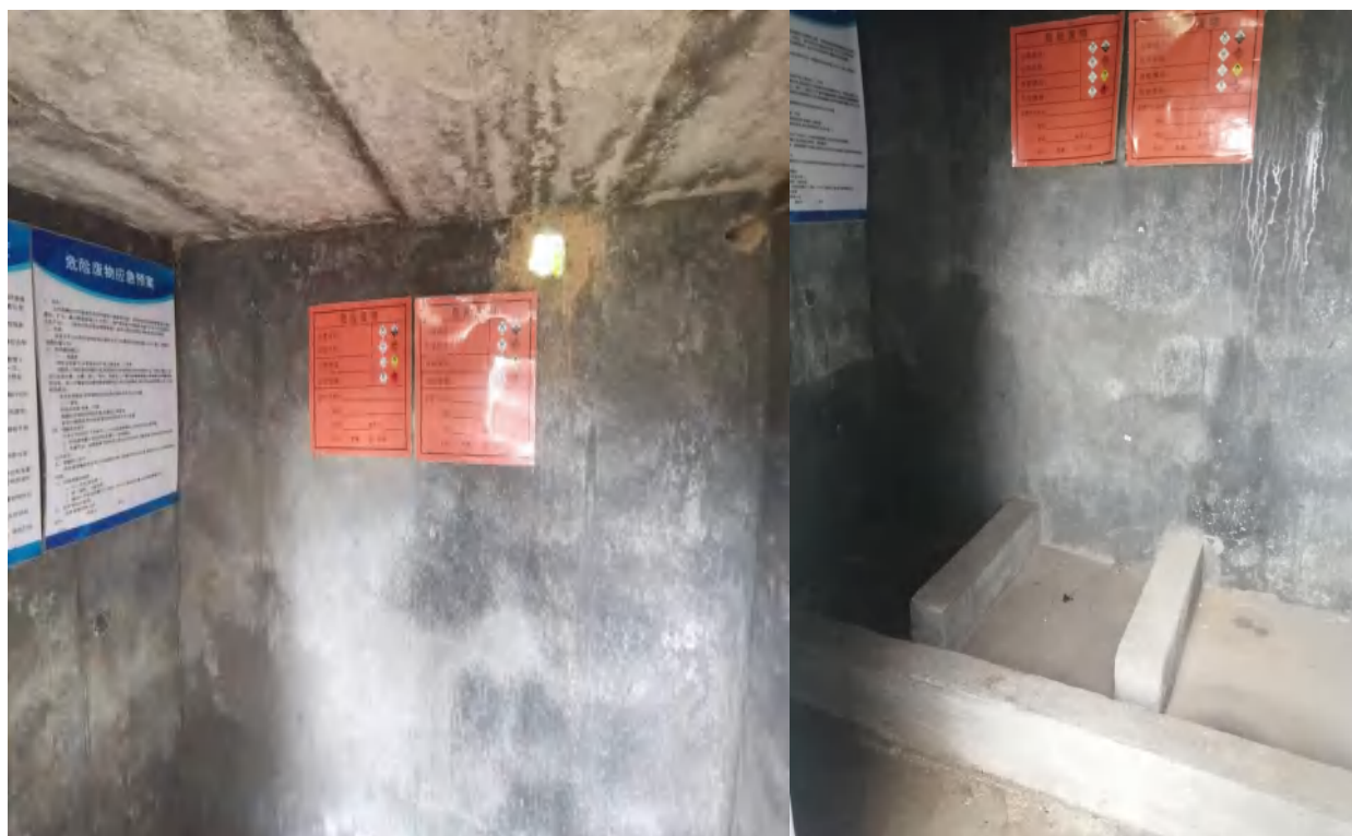
图 4-7 危废暂存库内部分类管理
