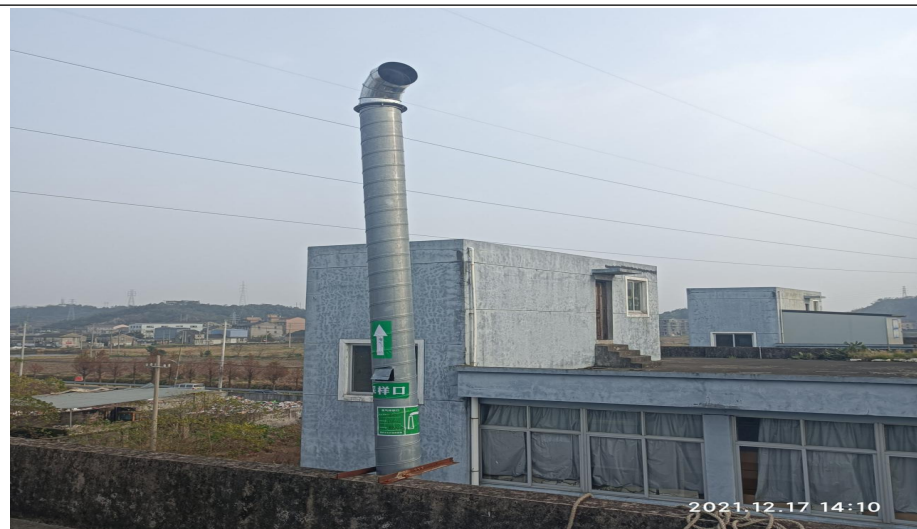
磨水口拉砂粉尘排放口
