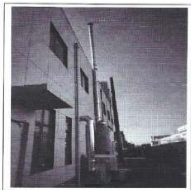
污水站脱臭及排气筒
