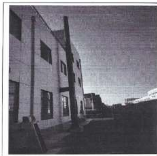
燃气锅炉排气筒
